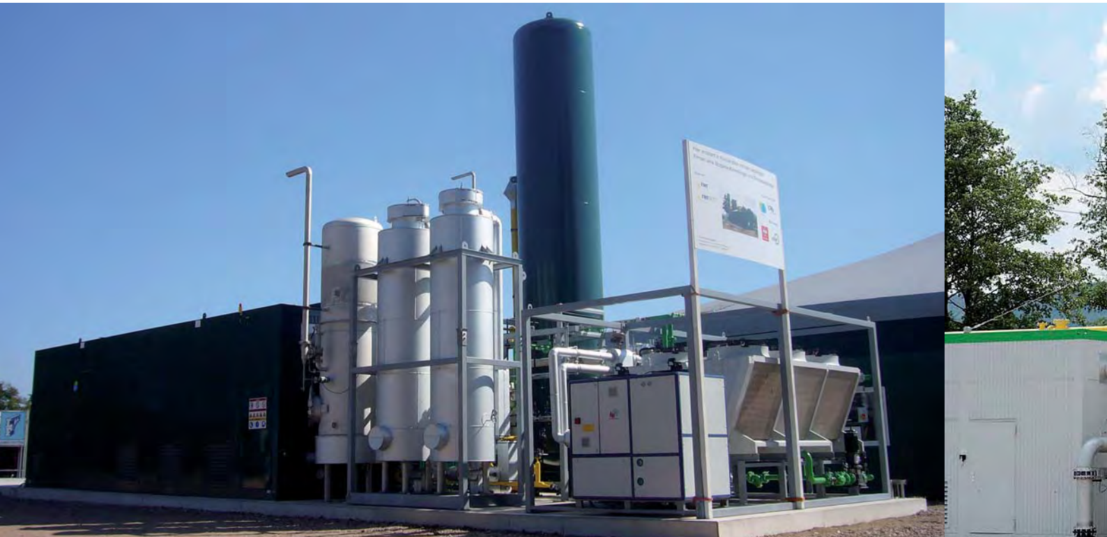
Biogas-Aufbereitungsanlage Wüstring/Oldenburg, Ostfriesland
