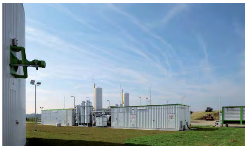
Aufbereitungsanlage für Bio-Erdgas, platzsparend in Standard-Containern installiert
