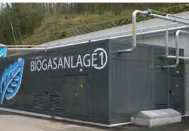
Das Rohgas für die Aufbereitungs- anlage im schweizerischen Bern wird aus Klärgas und Abfall gewonnen.
