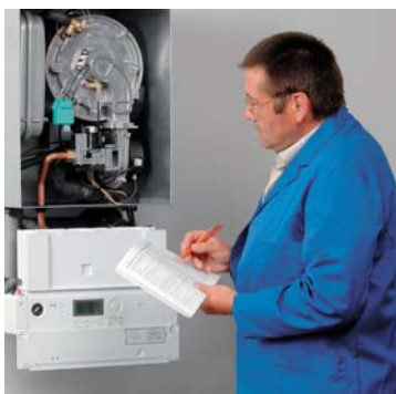
Fachkundige Wartung – bei Ihrem Heizungsfachbetrieb in den besten Händen
