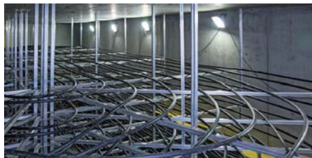
Blick in das Innere eines Eis-Energiespeichers.
