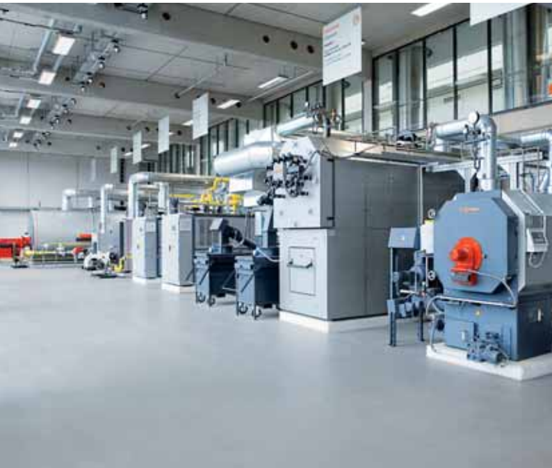
Energiezentrale am Unternehmenssitz in Allendorf (Eder)
