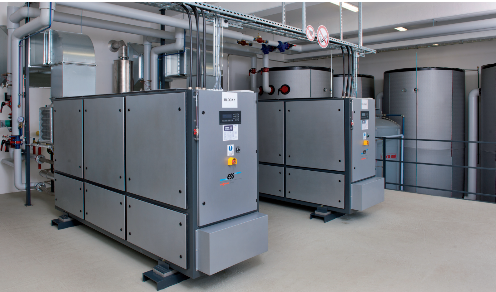
Die beiden Vitobloc 200 leisten je 140 kW el und 207 kW th .
