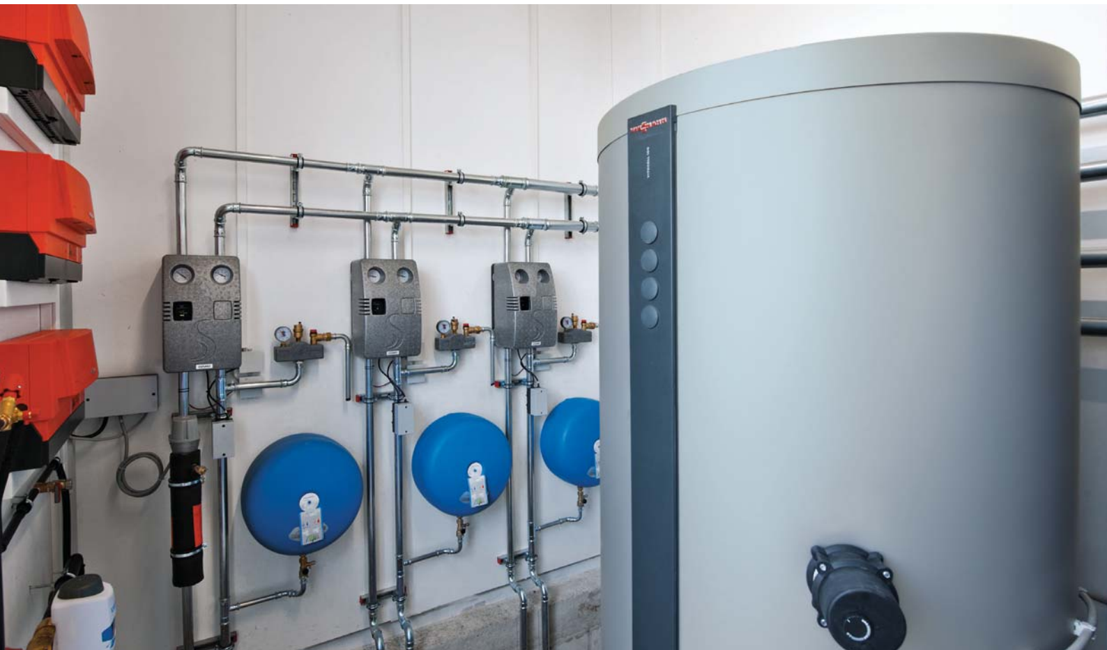
Übersichtliche Installation der drei Wärmepumpen mit Regelungen, Ausgleichsgefäßen und Heizwasser-Pufferspeicher Vitocell 140-E
