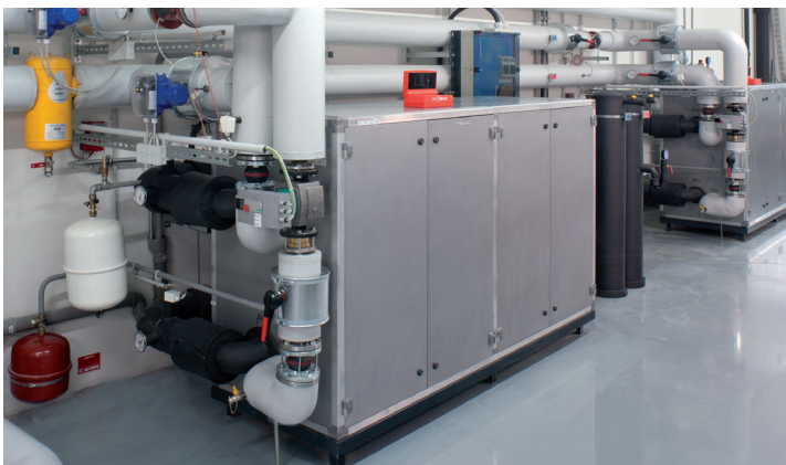
Zwei Wärmepumpen liefern eine Heizleistung von insgesamt 484 kW und eine Kälteleistung von 384 kW.
