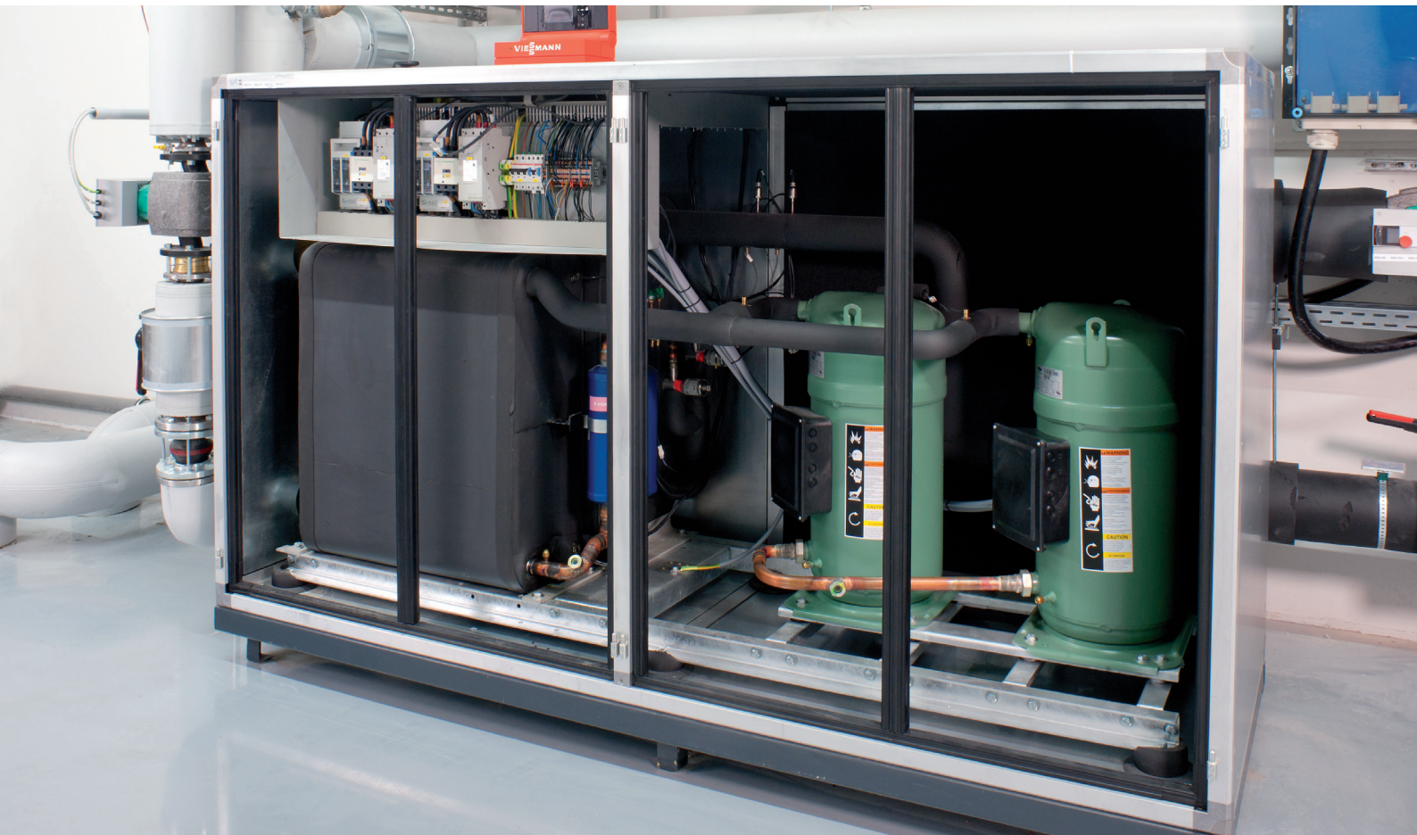
Blick auf die Verdichter in der Wärmepumpe Vitocal 300-G Pro
