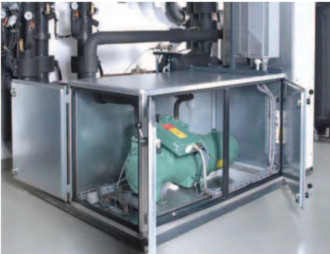
Blick ins Innere der Anlage: Der Schraubenverdichter ist hoch effizient; das Geräusch- und Schwingungsniveau ist niedrig.
