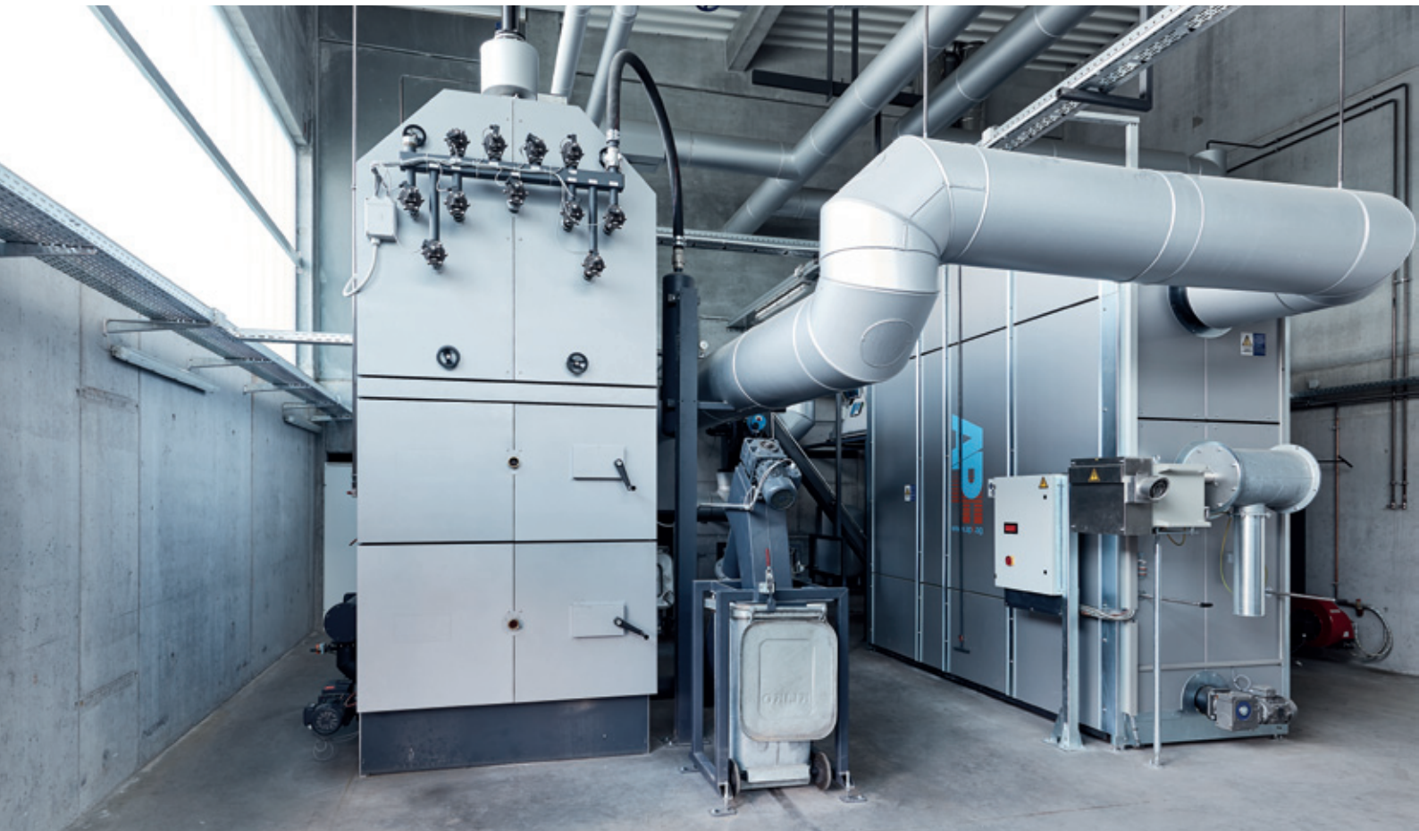
Biomassekessel Vitoflex 300-VF mit einer Leistung von 850 kW
