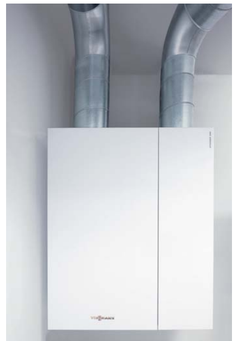
Im Abstellraum jeder Wohnung wurde ein Wohnungslüftungs-System Vitivent 300-W installiert.
