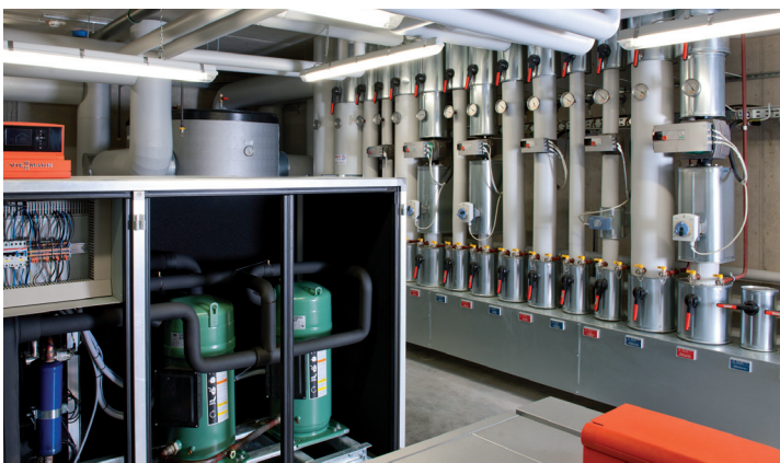
In der Vitocal 300-G Pro arbeiten zwei Scroll-Verdichter.
