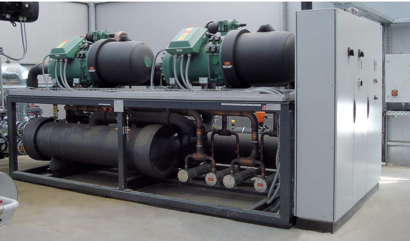
Großwärmepumpe von KWT mit einer Leistung von 1560 kW
