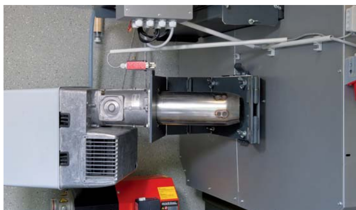
Ein einschwenkbarer Ölbrenner dient als Ausfallsicherung.
